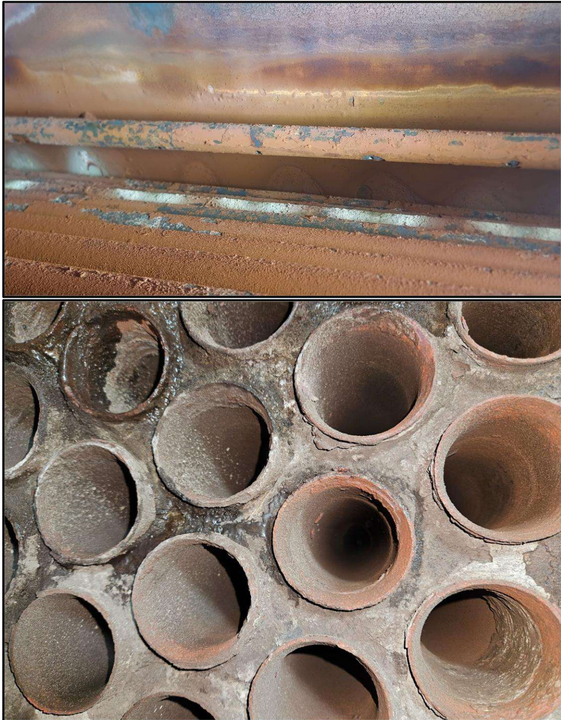
Figura 17-INTERNA DE TUBOS FLAMATUBOLAR TUBOS 2,5" SCH 40
