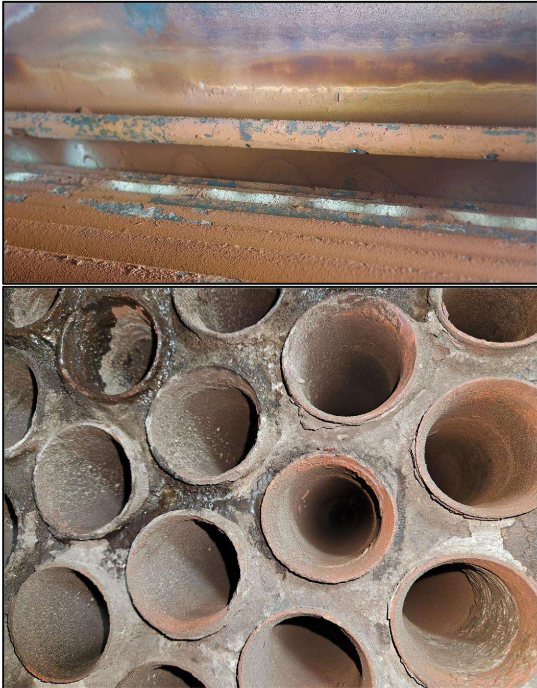
Figura 17-INTERNA DE TUBOS FLAMATUBOLAR TUBOS 2,5" SCH 40
