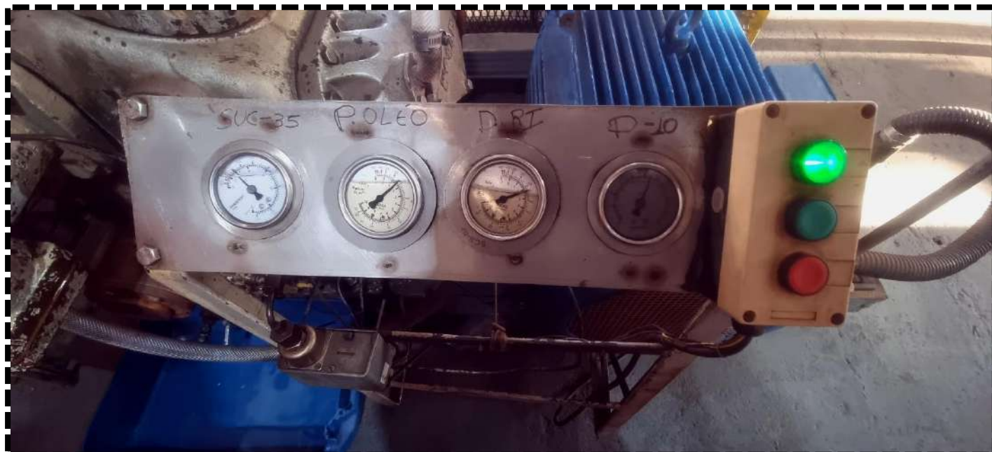
DISPOSITIVO DE LEITURA DE PRESSÃO INSTALADO NO VASO DE PRESSÃO
