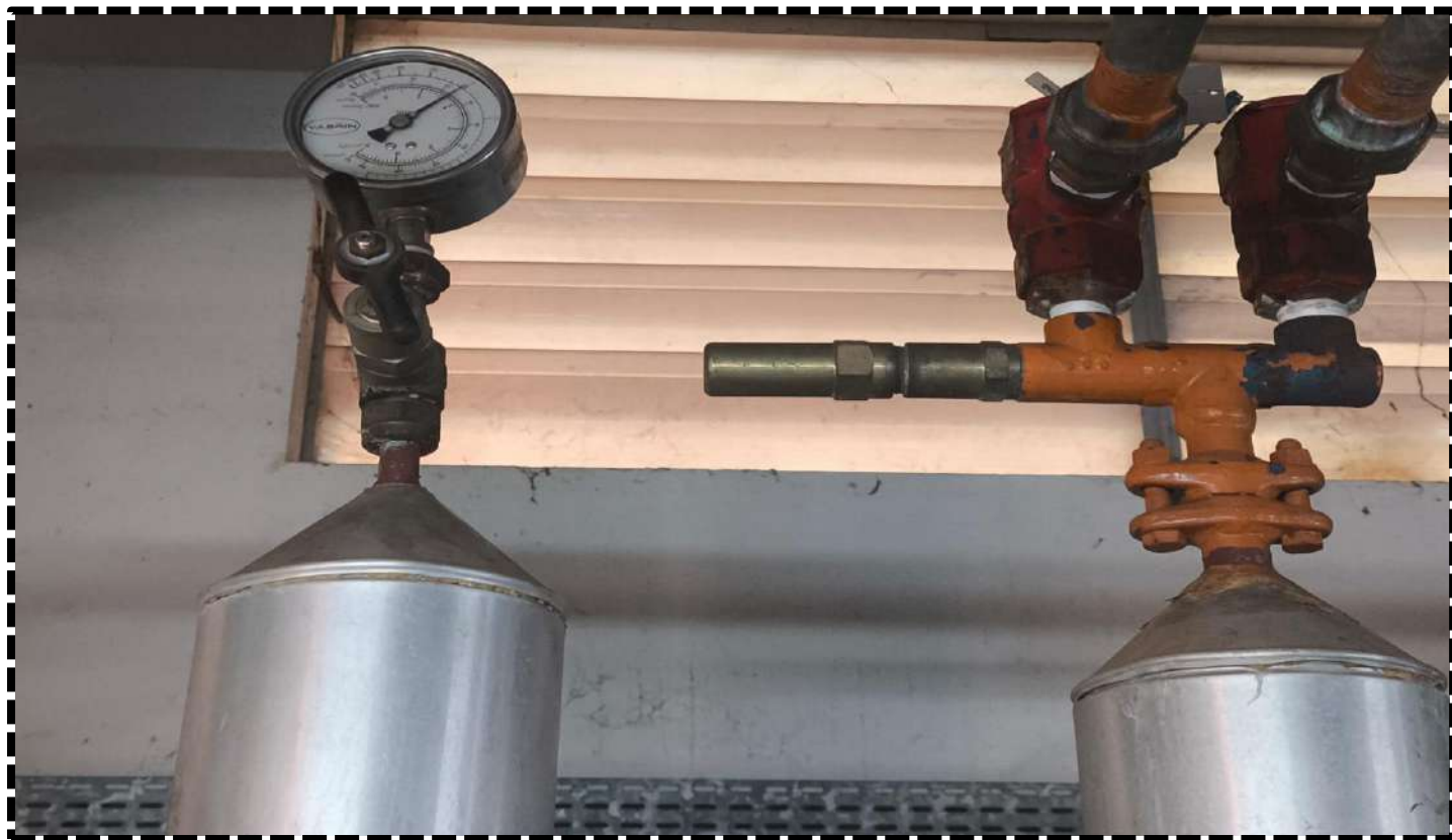
DISPOSITIVO DE LEITURA DE PRESSÃO INSTALADO NO VASO DE PRESSÃO
