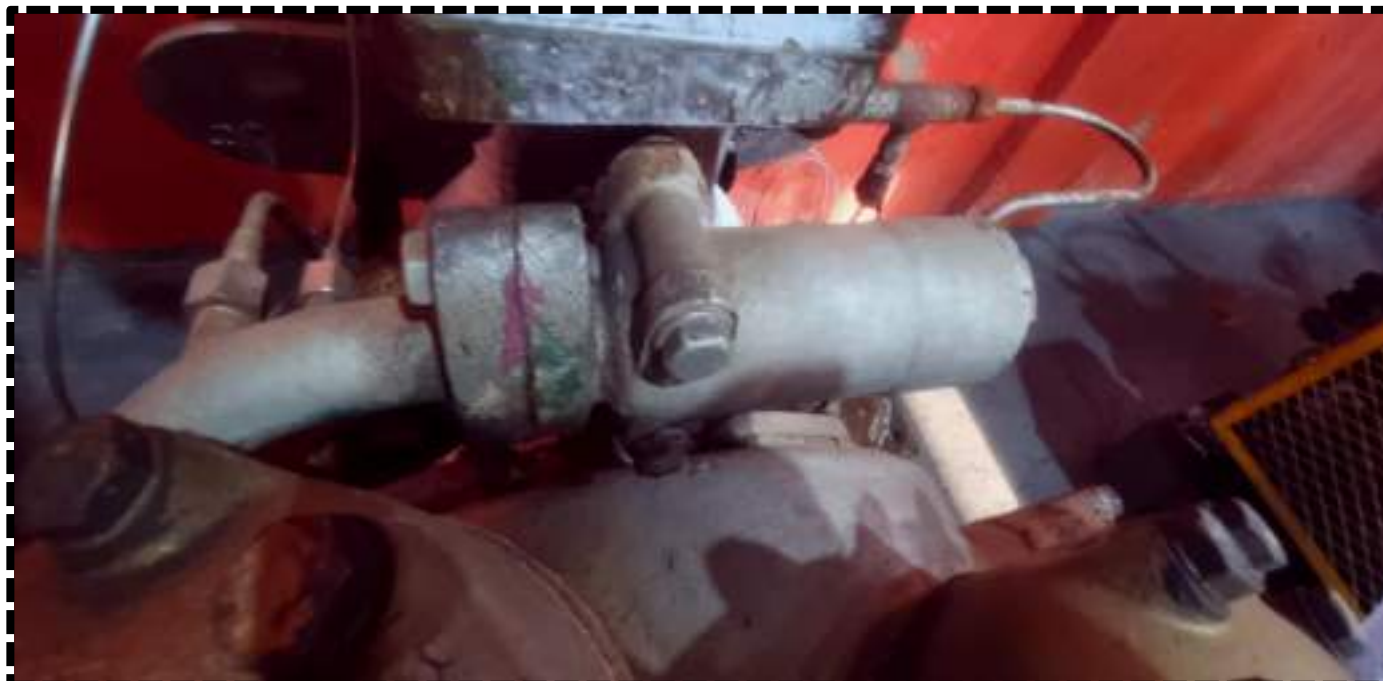
DISPOSITIVO DE SEGURANÇA INSTALADO NO VASO DE PRESSÃO
