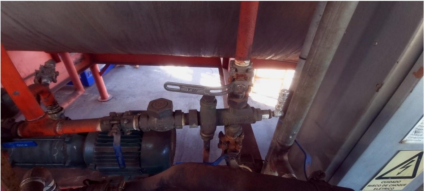
Figura 21 -INJETOR DE ÁGUA
