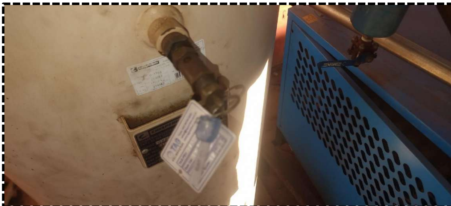
DISPOSITIVO DE SEGURANÇA INSTALADO NO VASO DE PRESSÃO
