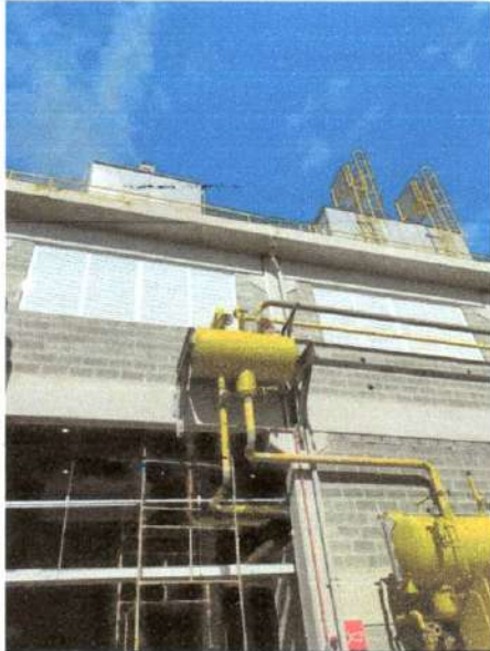
01 - Visão geral do equipamento
