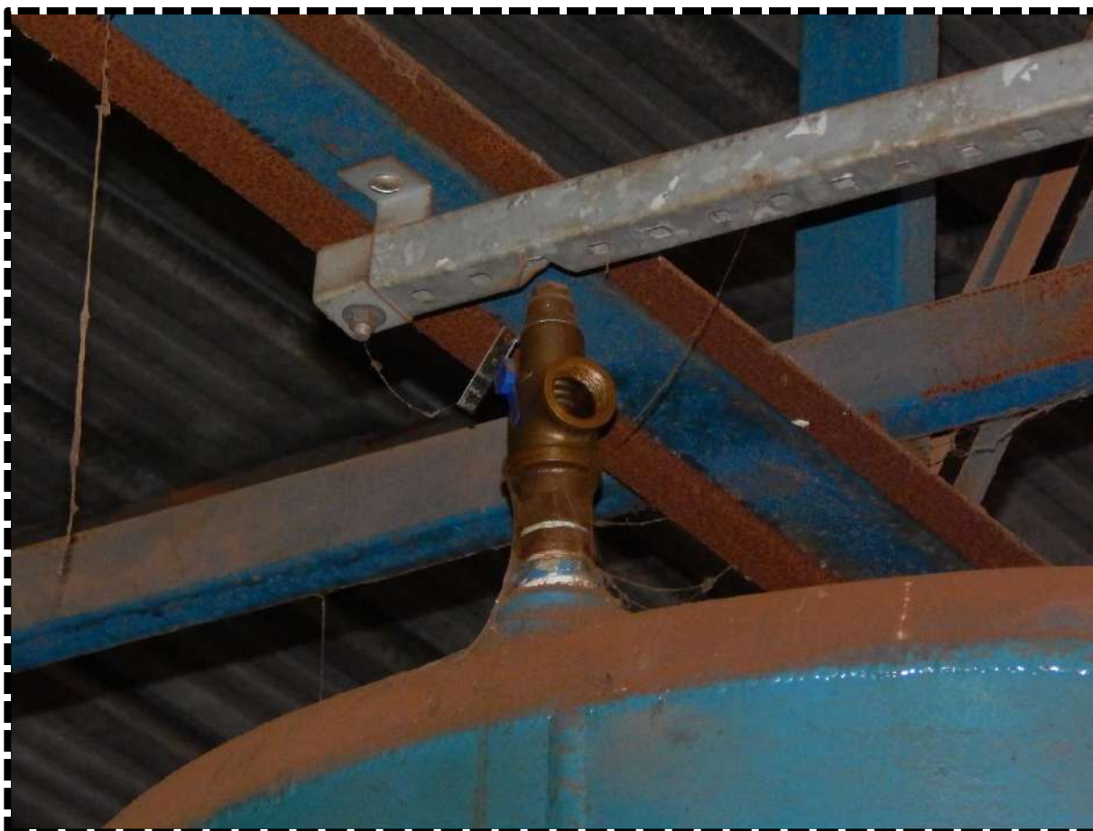
DISPOSITIVO DE SEGURANÇA INSTALADO NO VASO DE PRESSÃO
