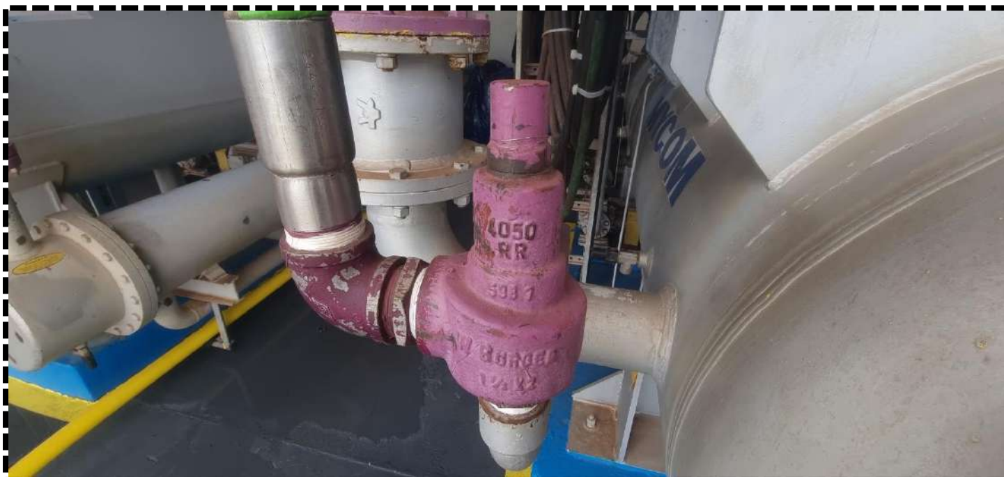
DISPOSITIVO DE SEGURANÇA INSTALADO NO VASO DE PRESSÃO
