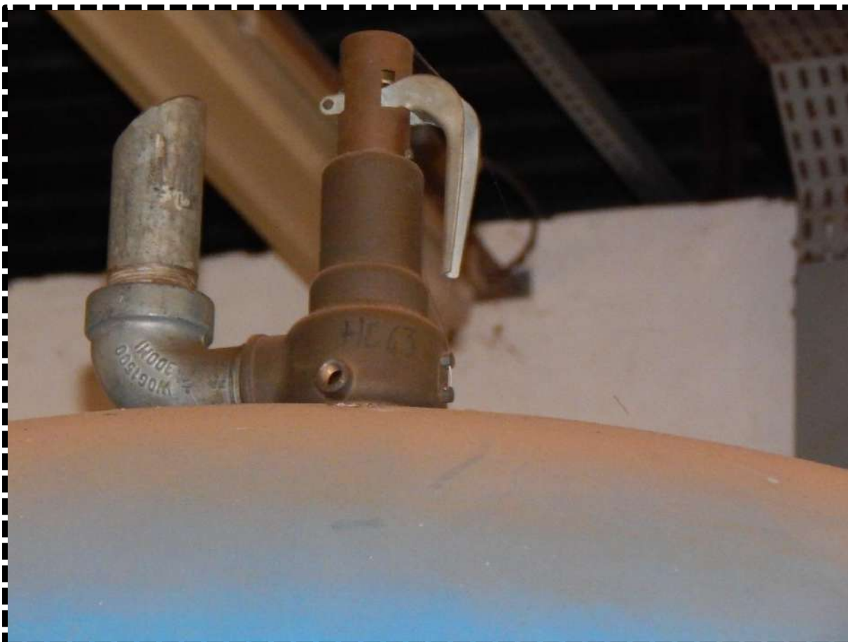
DISPOSITIVO DE SEGURANÇA INSTALADO NO VASO DE PRESSÃO
