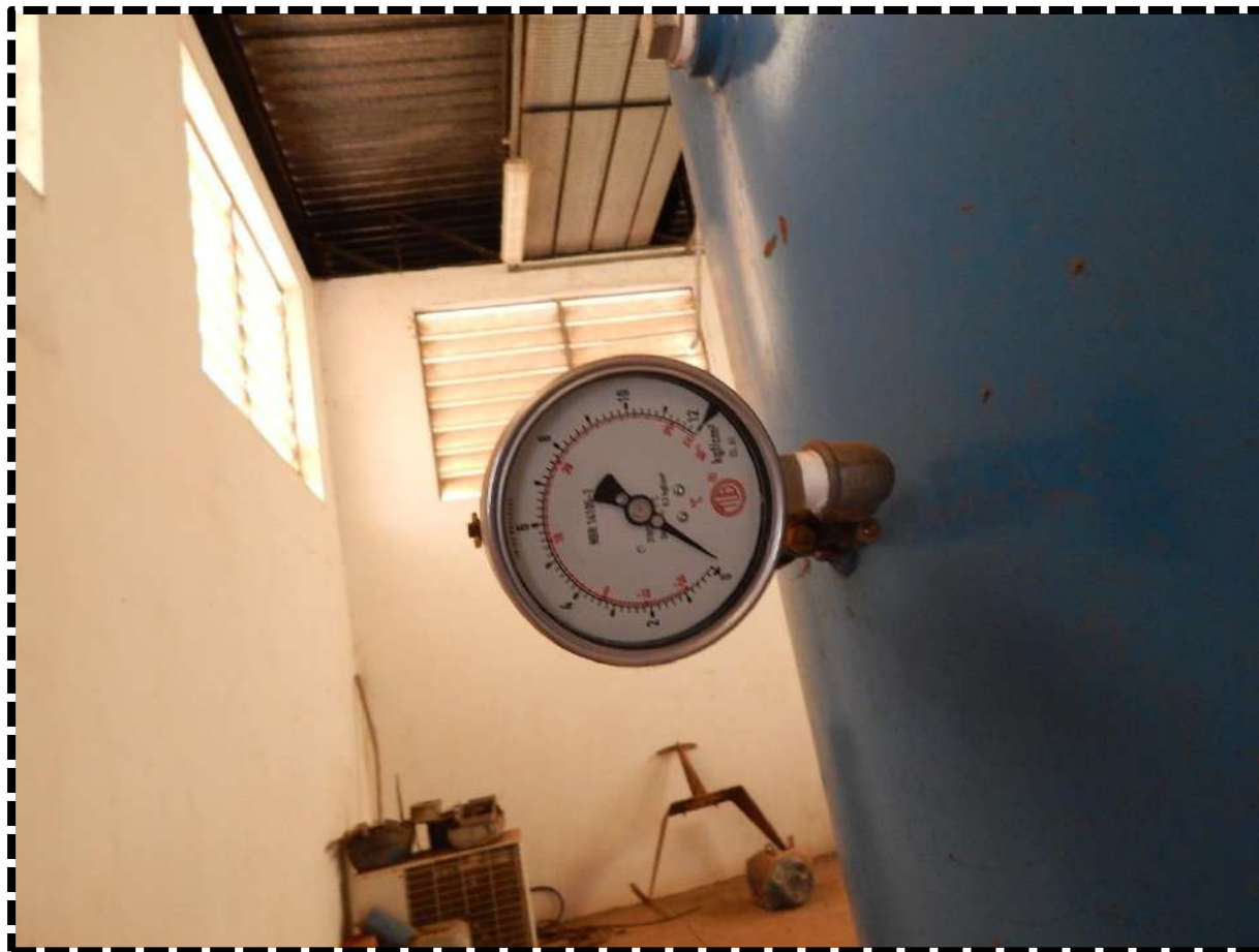
DISPOSITIVO DE LEITURA DE PRESSÃO INSTALADO NO VASO DE PRESSÃO
