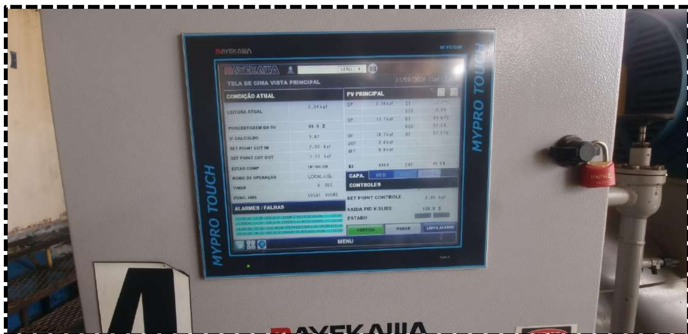
DISPOSITIVO DE LEITURA DE PRESSÃO INSTALADO NO VASO DE PRESSÃO
